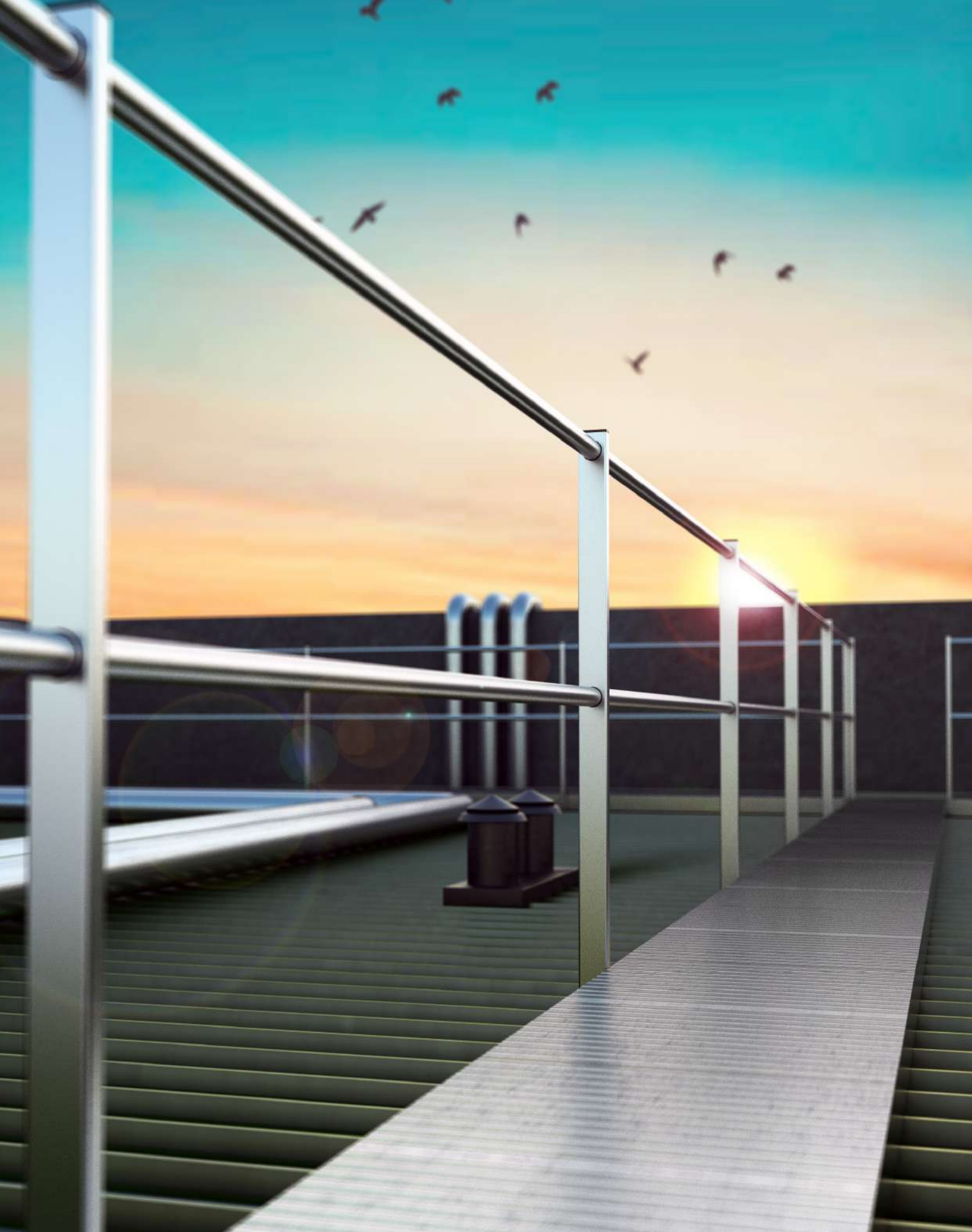
Passerella con protezione monolaterale su copertura industriale
